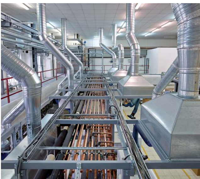
V testovacom centre v Protherm Production zmodernizovali aj rozvody plynov k novým testovacím zariadeniam
