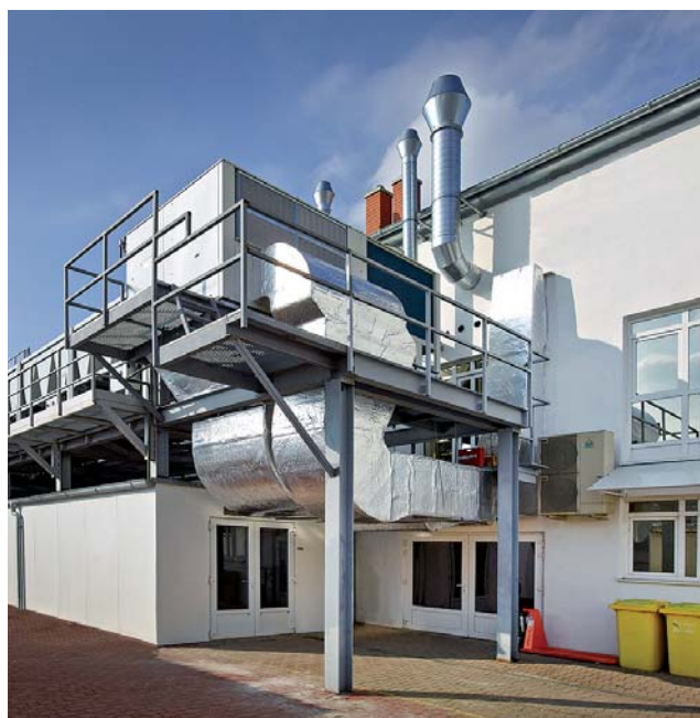
Súčasťou zmodernizovaného testovacieho centra Protherm Production je aj nová výkonná klimatizačná jednotka
